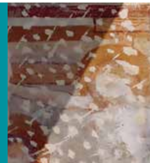
Slika 8: Primer detajla stenske slike, na kateri poškodbe povzročajo motnje v zaznavanju oblik in hkrati silijo v ospredje v obliki, ki spominja na snežne padavine (del stenske slike je v senci). Osebni arhiv in foto: B. Šeme.
