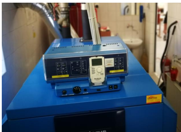
Slika 8: Kotel na zemeljski plin
